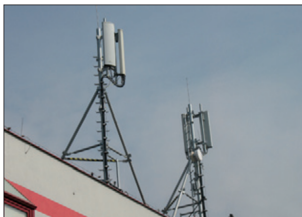
Anteny radiokomunikacyjne na dachu budynku
