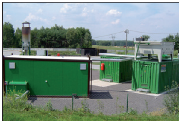
Instalacja do produkcji energii z wykorzystaniem biogazu w Promniku
